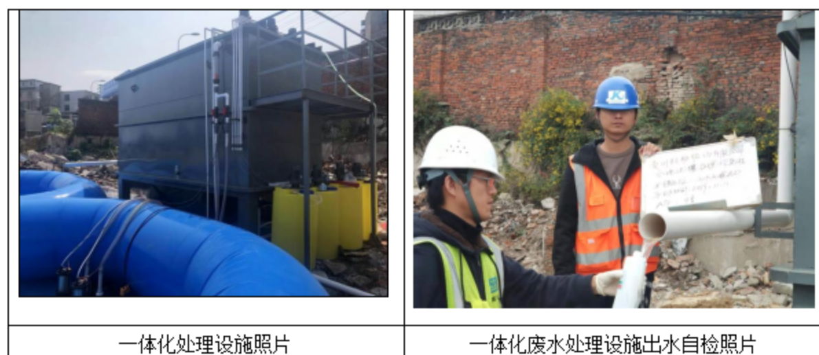
图 3-5 一体化污水处理设备及出水采样监测照片
