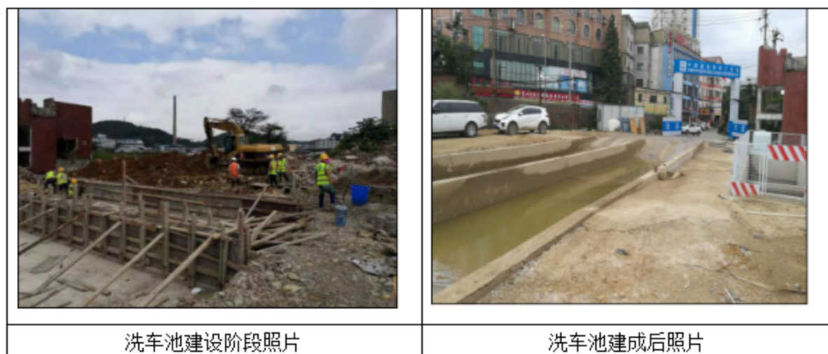
图 3-6 施工期水污染防治设施洗车池照片
